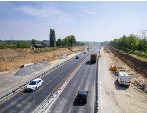
Pour assurer la continuité de la circulation tout au long des travaux, des fermetures de voies sont parfois nécessaires de jour ou de nuit.
