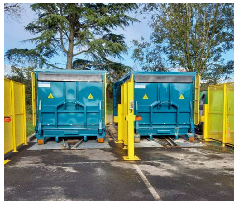
Compacteurs sur la déchèterie de Carquefou
